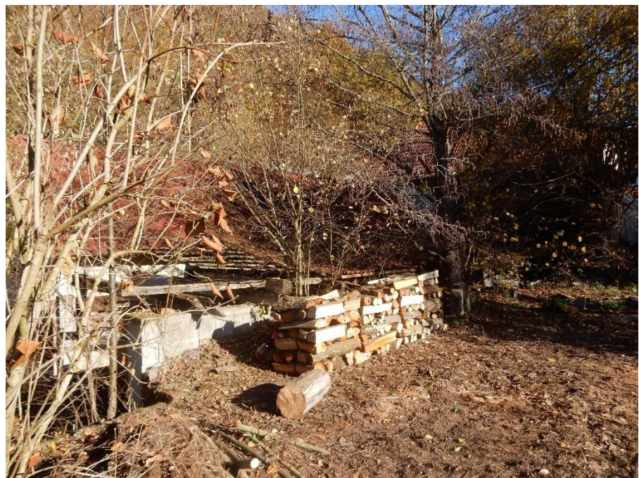
Foto 5: Ruinöser Schuppen mit Holzstapeln und Wohngebäude (im Hintergrund)
