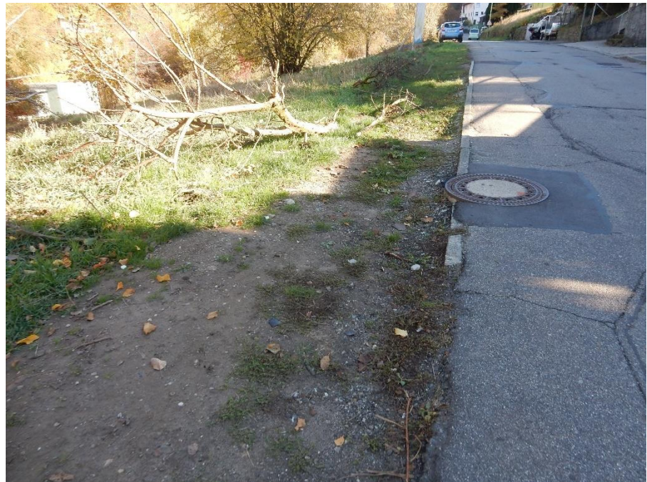
Foto 4: Überfahrtschäden in den Randbereichen des Grünlandes an der Alten Dielbacher Straße
