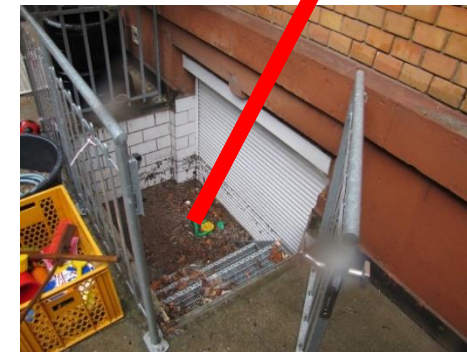
Abb.: Überflutung einer Kita im August 2020; wie durch die SRGK prognostiziert, ist das Wasser durch einen ebenerdigen Lichtschacht eingedrungen.
