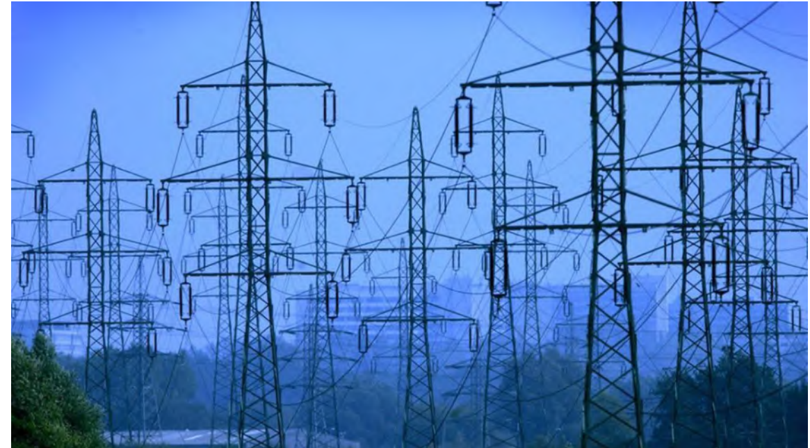
Problembereich II Energieverteilung
